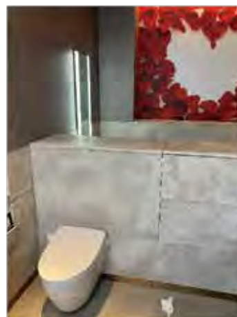
⑥デラックストイレ内の VIP トイレ
