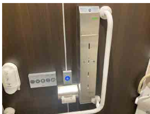
大阪駅のうめきたエリアのトイレトペーパーホルダー。この中に特別なセンサーが内部に組み込まれています。
